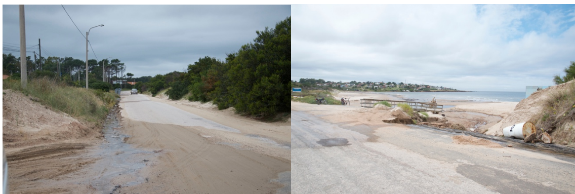
Figura 4. Rambla costanera de San Francisco-Punta Colorada. Izquierda: pluviales paralelas a la rambla, erosionando capa asfáltica. Derecha: descalce de bajada peatonal, erosión de duna y de parte de la capa asfáltica de la rambla en pasaje de cañada que desagota en la playa.
